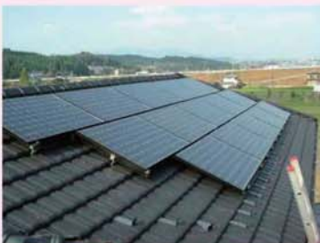
太陽光発電パネル（南東側屋根）
